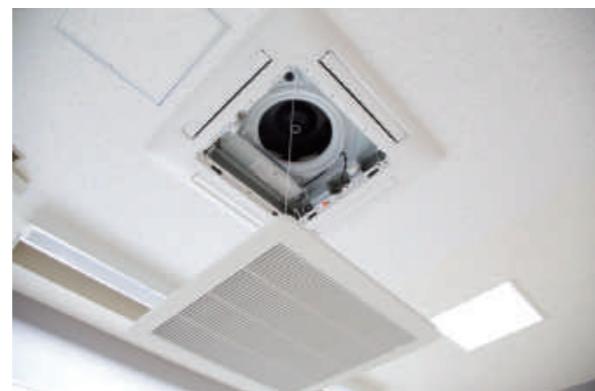
【写真2】電動昇降式の室内パネル
