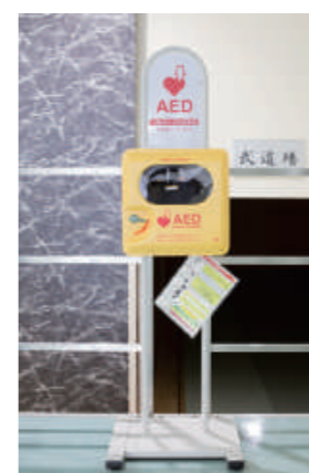
【写真】体育館内に設置されている AED
