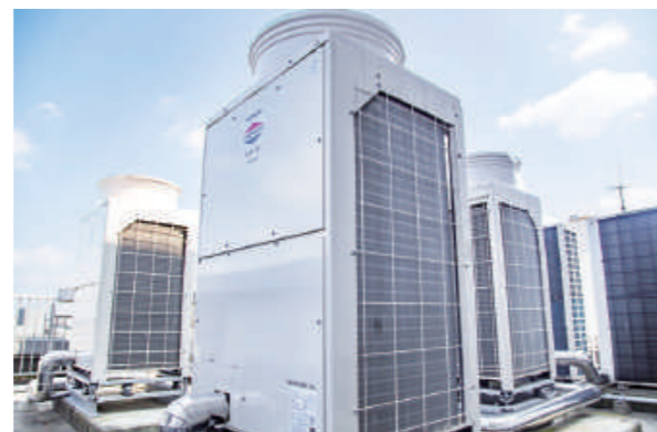
【写真1】更新された新しい空調室外機(東6号館)
