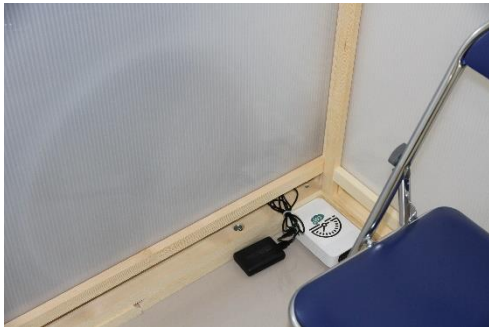
CO 2 センサーの設置例
