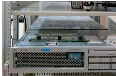
研究室にある計算機室の一部
